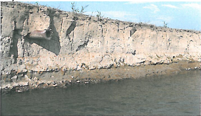
Osiřelá meliorační výpust'
