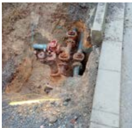
Před opravou - Lesní správa
