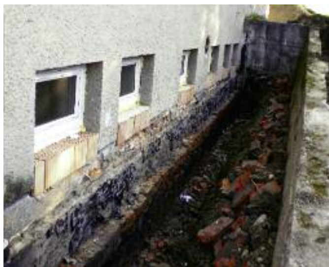
Staré základy je nutno zaizolovat proti vlhkosti
