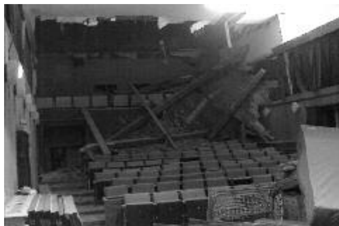
Zřícenina stropu kinosálu — srpen 2008
