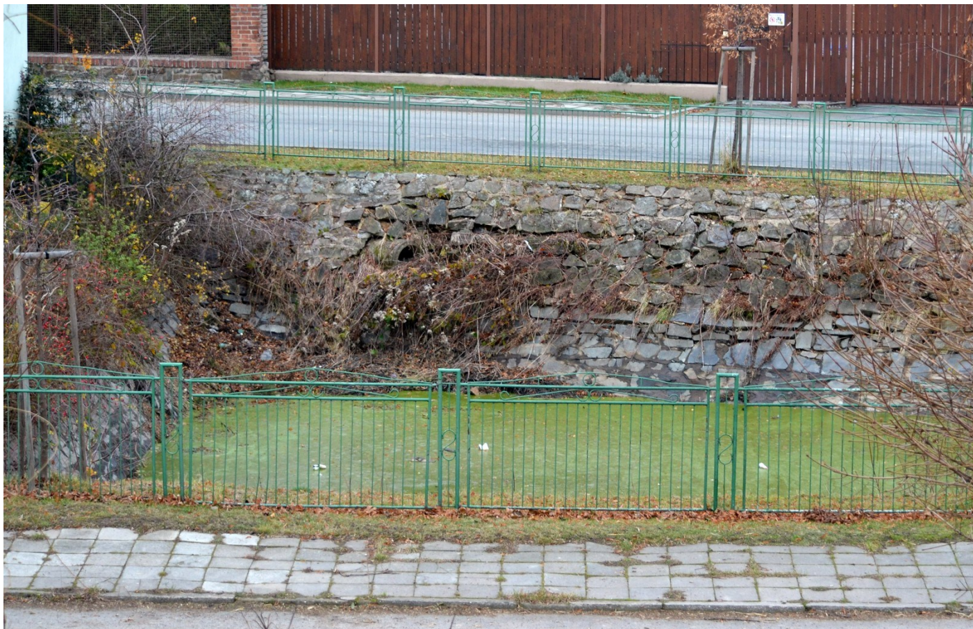
Dolní požární nádrž před opravou
