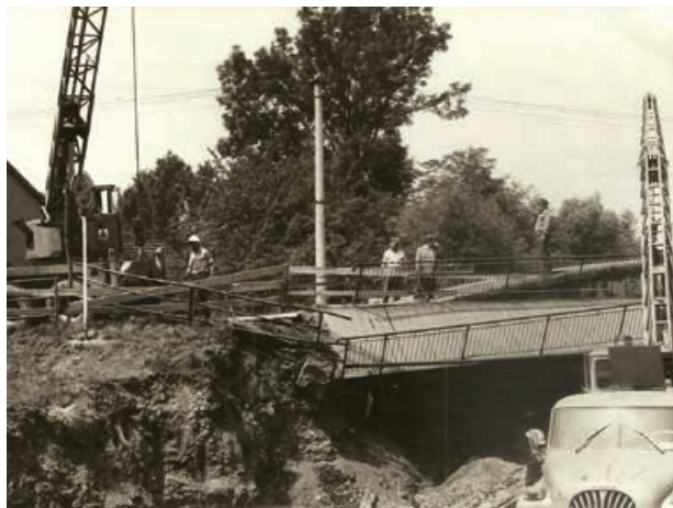
▲ Před 40 lety v létě 1978 došlo při opravě potoka Bys-trého před Baštankou k nehodě. Při podkopání základu lávky, se tento základ uvolnil a spadl do potoka. Uvolněný betonový kvádr ohrozil jednoho z pracujících dělníků, kterého se naštěstí podařilo zachránit.
