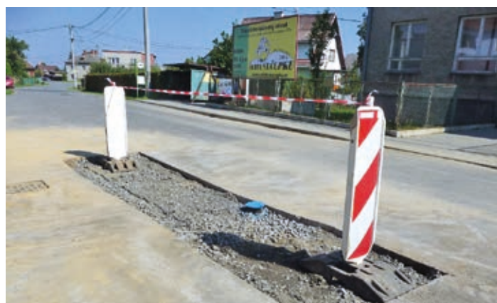
Několikanásobné prasklé potrubí vodovodního řádu v centru obce Hodoňovice znepříjemnilo poutové veselí.
