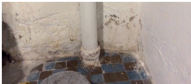
Kanalizační rozvody v Kunčičkách u Bašky
