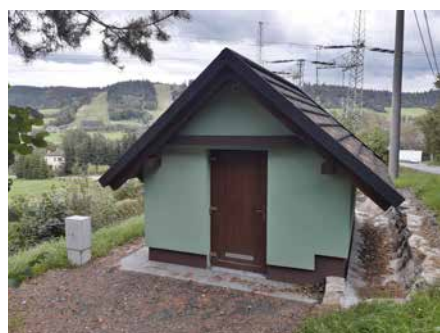
Automatická tlaková stanice Boroví
