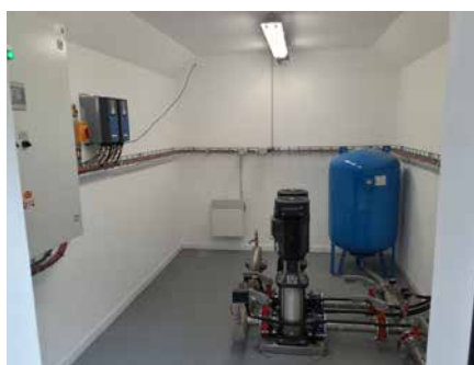
Automatická tlaková stanice Boroví
