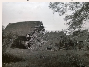
Pohled na chátrající budovy Dvořiska
