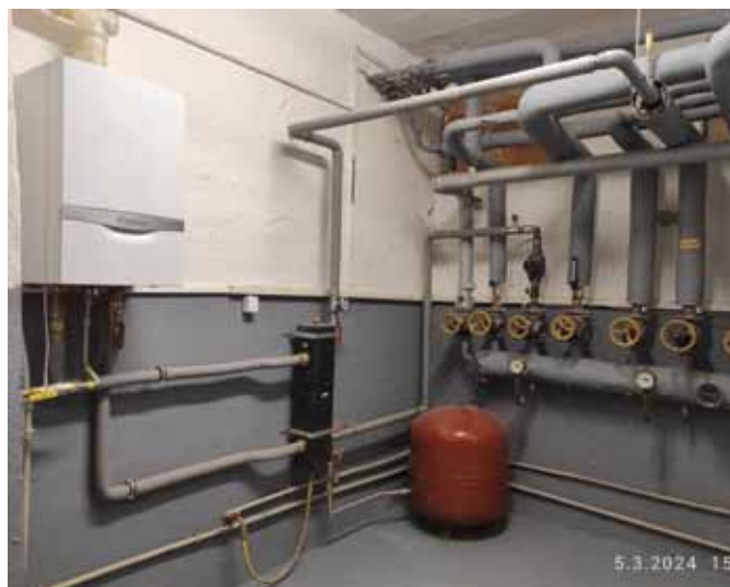
Kotel VAILLANT VU 486-5 ecoTEC plus stav po rekonstrukci kotelny
