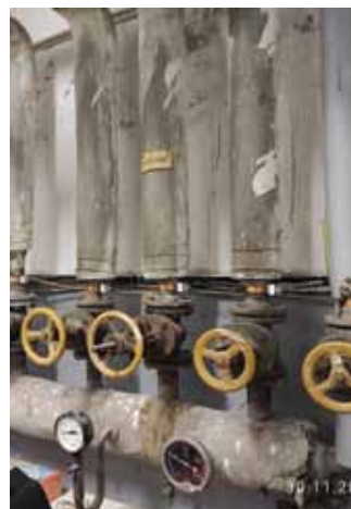
Oběhové čerpadlo ve zpětném potrubí
