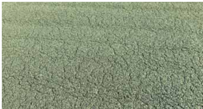
Poškození mnohých bitumenových pásů
