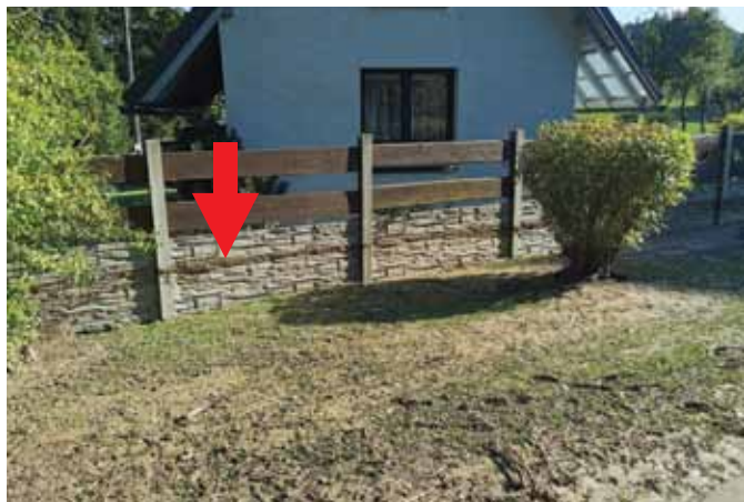
Výška protékající vody způsobená ucpaným propustkem
