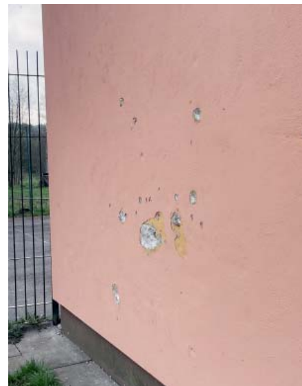
Zničená fasáda na budově tělocvičny u dětského hřiště v Horních Datyních.
