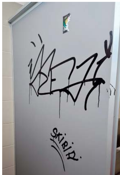
Posprejované kabinky na veřejném WC ve sportovním areálu Vratimov.
