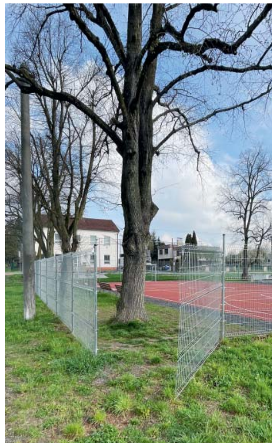
Vykopnutý plot na víceúčelovém hřišti naproti ZŠ Horní Datyně. Foto: MěÚ
