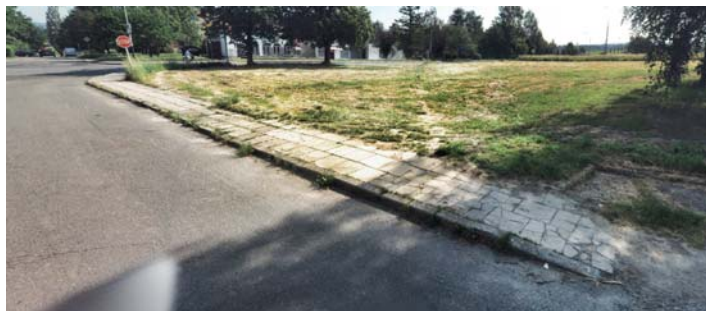
Chodník Na Příčnici před opravou.
