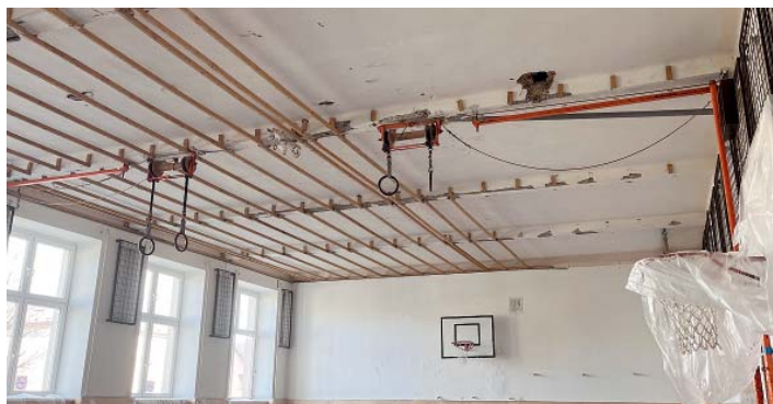
Podhled tělocvičny před opravou.
