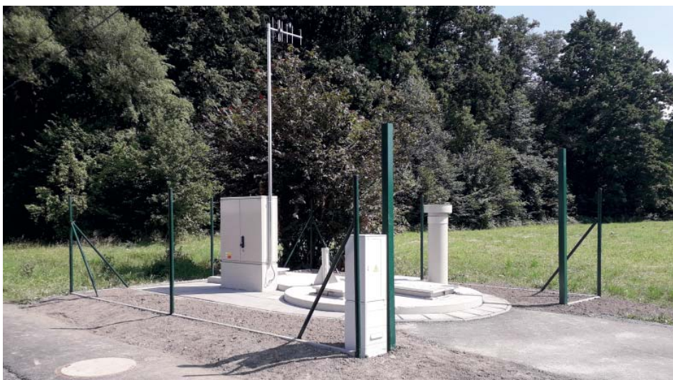
Čerpací stanice ČS4 v ulici U Mostku.
