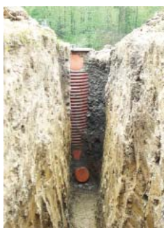
Revizní šachta s odbočným místem pro kanalizační přípojku.
