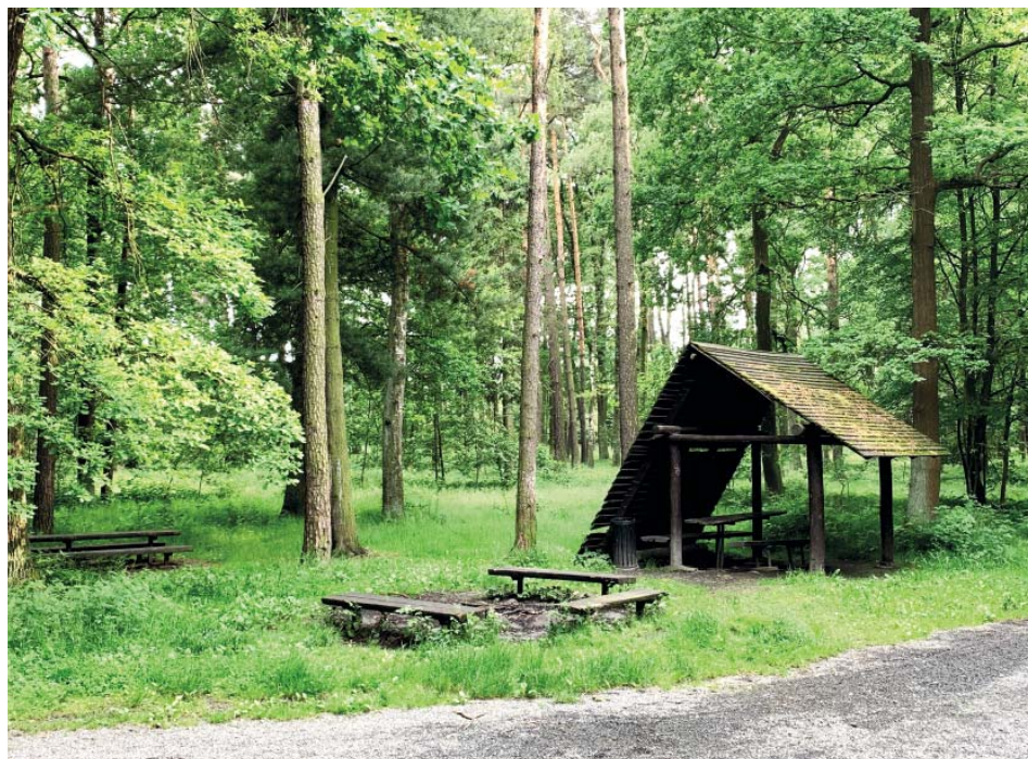
Přístřešky u odpočinkových míst už naléhavě potřebují opravu.
