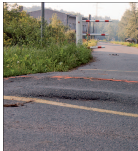
Nerovnosti povrchu jsou nebezpečné foto (jk)
