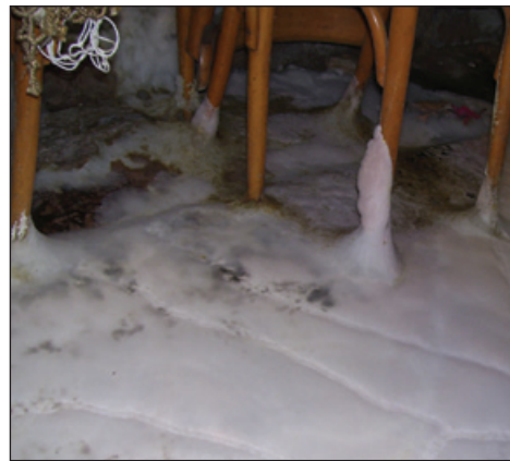
Stav před rekonstrukcí – plíseň na podlaze a stoupající po židlích foto Hana Bömerová
