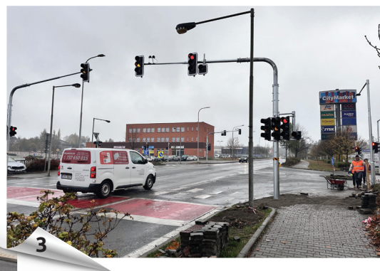
3) Světelné signalizační zařízení (Tesco)
