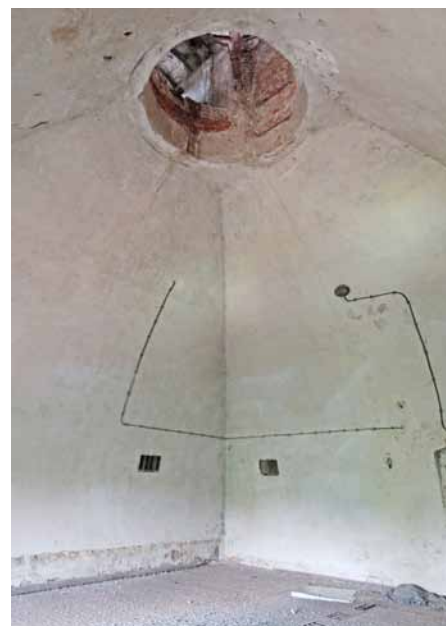
Pohled na odvětrávací systém v jedné z věží
