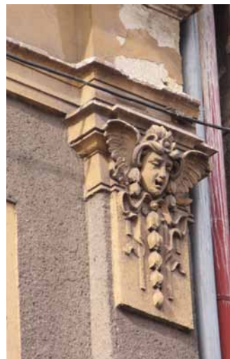
Detail před opravou
