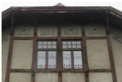
Chybějící vzpěry v hrázdění nad oknem
