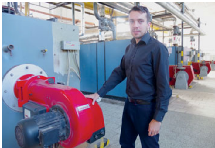
Dariusz Cymerys, který nově vede Teplota Těšína, v kotelně.
