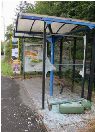
Zastávka pod Mosteckým kopcem po řádění vandalů.
