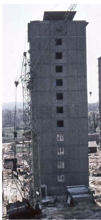
Nápor větru jeřáb nevydržel, našťastí se opřel o sousední věžák.
