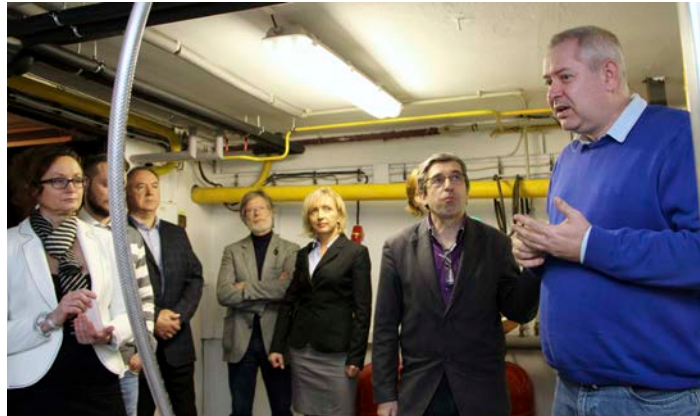
Bohumil Horák z VŠB-TU Ostrava provedl zájemce podzemím Trianonu, kde jsou nainstalovány kogenerační jednotky, zásobníky a tepelné čerpadlo.
