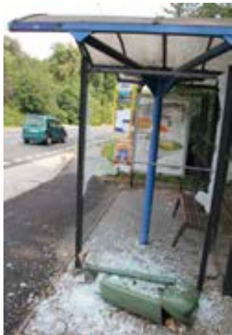
Neznámí vandalové takto zničili v srpnu zastávku v Ostravské ulici. U některých útoků jsou náklady na odstranění následků mnohem vyšší.
