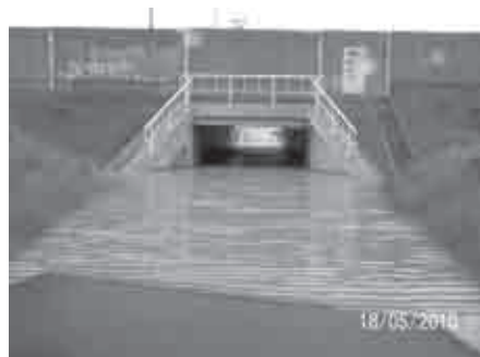
Místní část Dubí – zatopený podchod pod dálnicí D1
