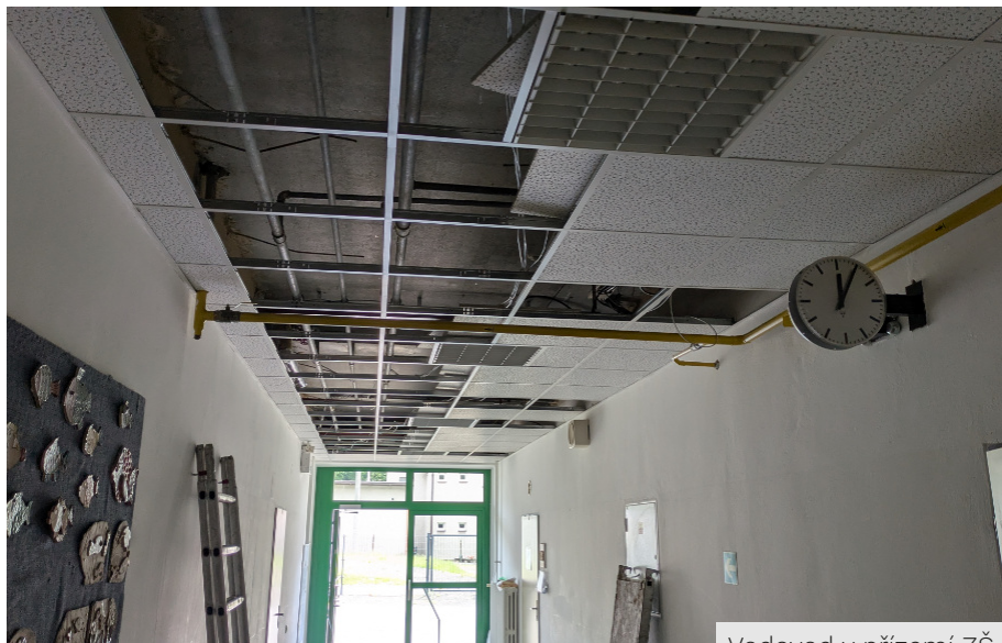
Vodovod v přízemí ZŠ
