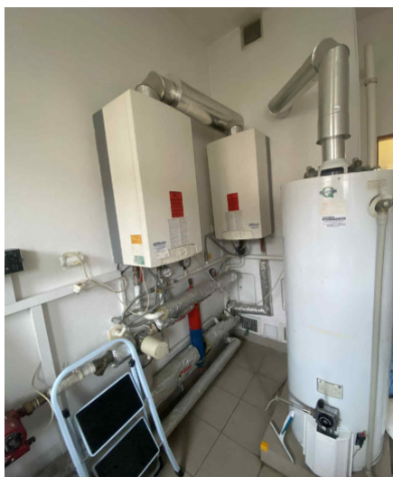
Nový kotel v MŠ - budova Nad Zámkem
