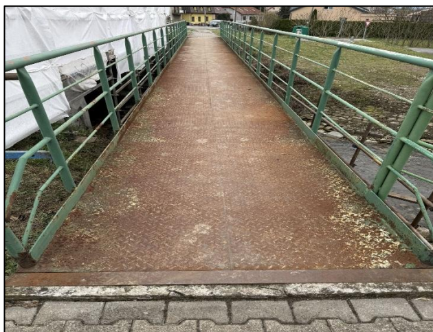
stav před opravou
