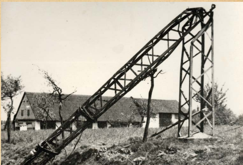
Zničený sloup elektrického vedení na Gregárkově ulici.
