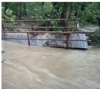
Spadlý most přes řeku Hvozdnici
