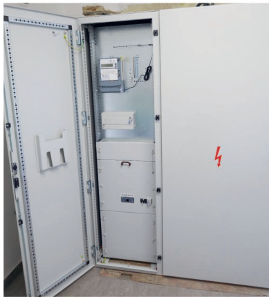
nový elektrorozvaděč v ZŠ Slavkov
