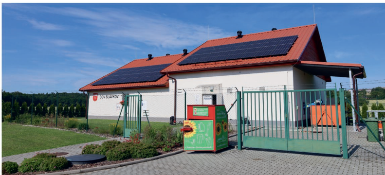
fotovoltaické panely na čističe odpadních vod
