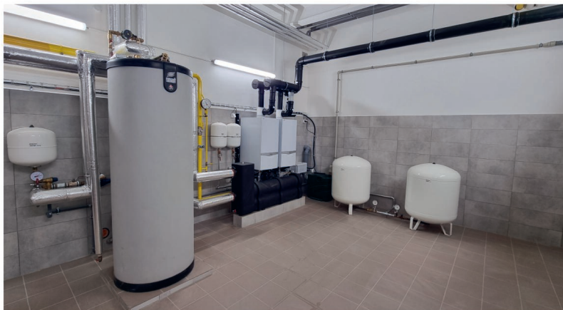
nová plynová kotelna základní školy
