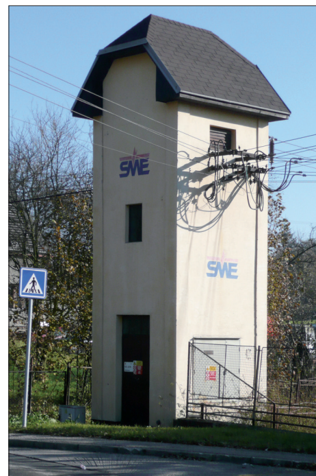
Transformační stanice na Podlesí
