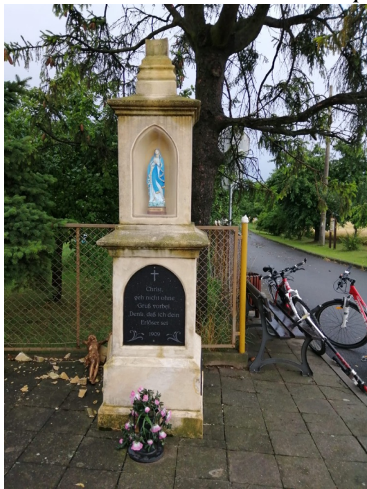
poškozený kříž na ulici Slezská před čp. 132
