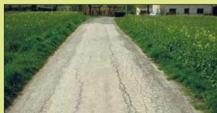
ul. V Olšíně – před opravou
