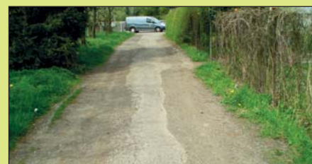
ul. Hraniční – před opravou
