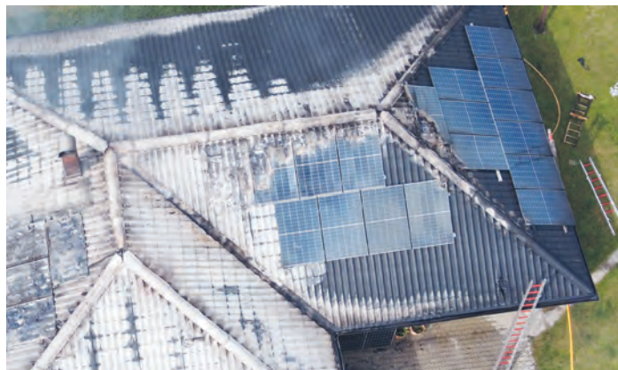
Technická závada může způsobit i požár solární elektrárny.
