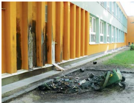
Novou fasádu základní školy zničil požár. Foto: Prokop Jirsák
