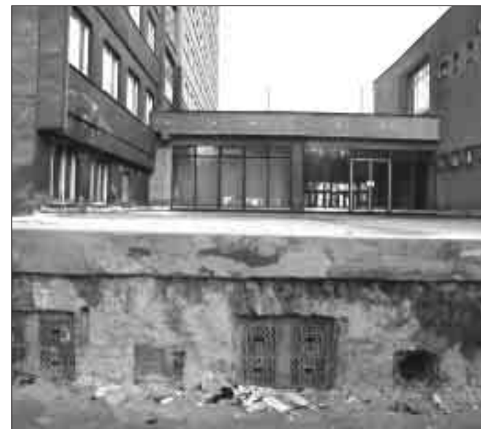
▲ Hotelový dům je v hrozném stavu, bez rekonstrukce nemá šanci.
