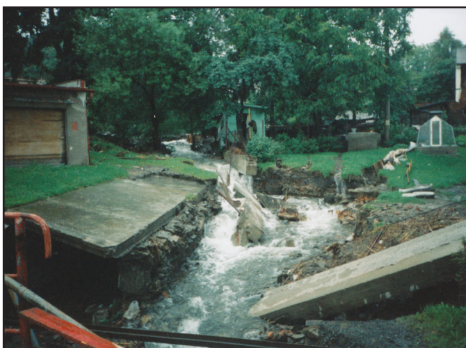
Slunečná - poškozený můstek (Lubomír Ondračka)
