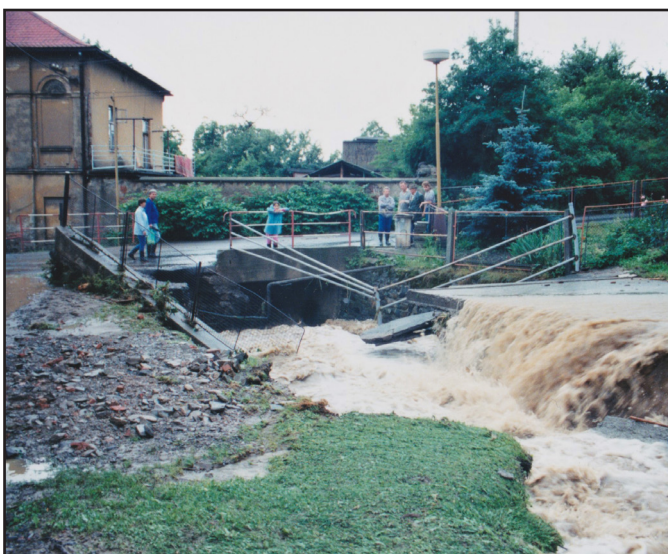
Poškozený můstek na Slunečné ulici u zvláštní školy (neznámý autor)
