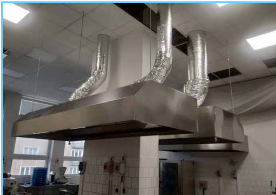
Vzduchotechnika - jídelna ZŠ Komenského
