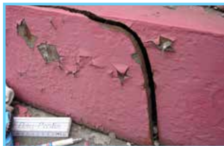
Prasklá základna z levé strany
