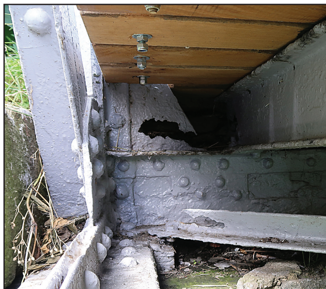
Poruchy a chátrání mostní konstrukce, pilířů a nábrežních zdí (Foto Emil Mateiciuc)
