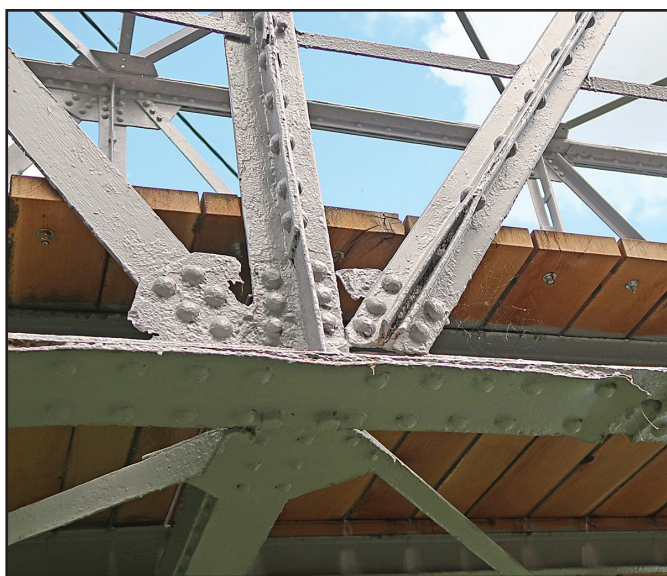
Poruchy a chýtrání mostní konstrukce, pilířů a nábrežních zdí (Foto Emil Mateiciuc)
