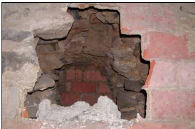
Foto č. 14 - Nedokonale zazděný prostup do sklepení domu Šubrtových
