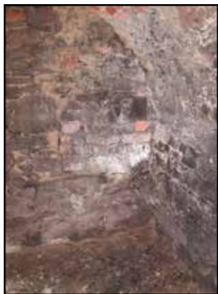
Foto č. 29 - Zazděný únikový východ z renesančního sklepení
