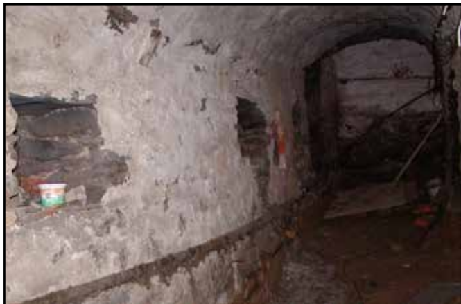
Foto č. 12 - Nezaklenuté výklenky v chodbici ze strany domu Šubrtů
