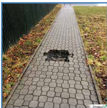
„Propadlý chodník mezi Benzinou a domovem důchodců. Vypadá to, že to vymlela voda (asi prasklé potrubí)“
