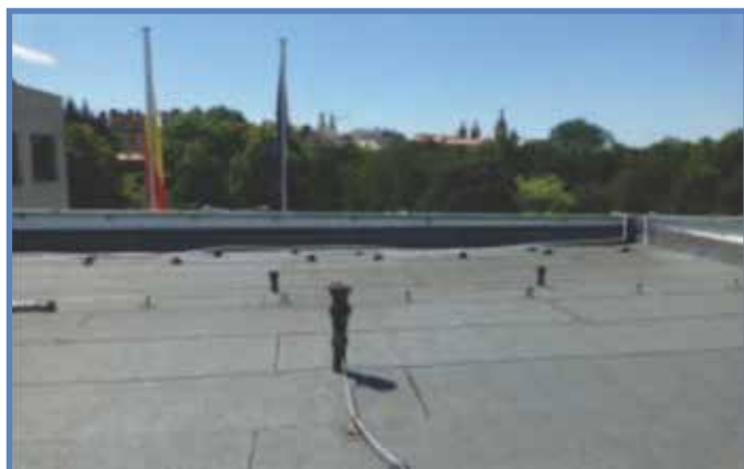
Asfaltový povrch střechy má v poledne teplotu 63°C
