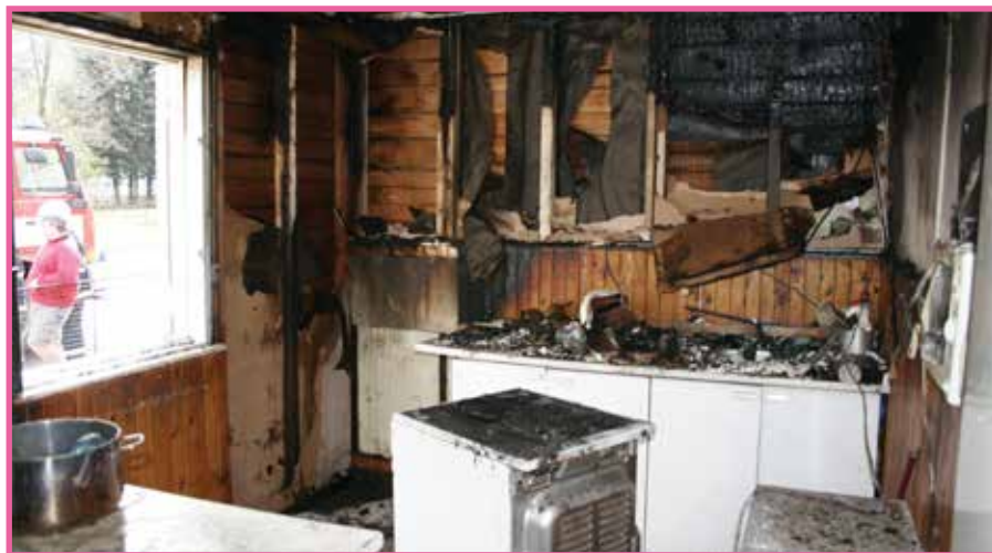
Následky ničivého požáru v roce 2014.
