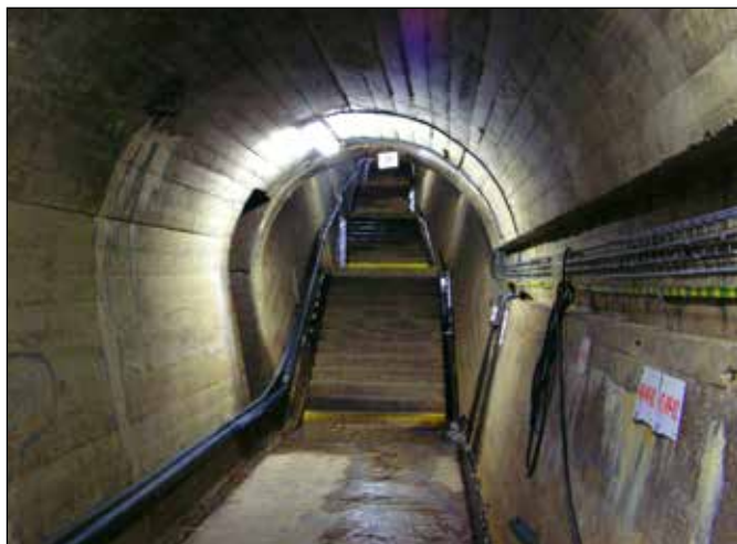
Revizní šachta v hrázi přehrady, Foto Ondřej Tomický, 2011
