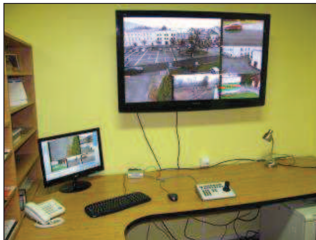
„Monitorovací stanoviště městského kamerového dohlížecího systému“
